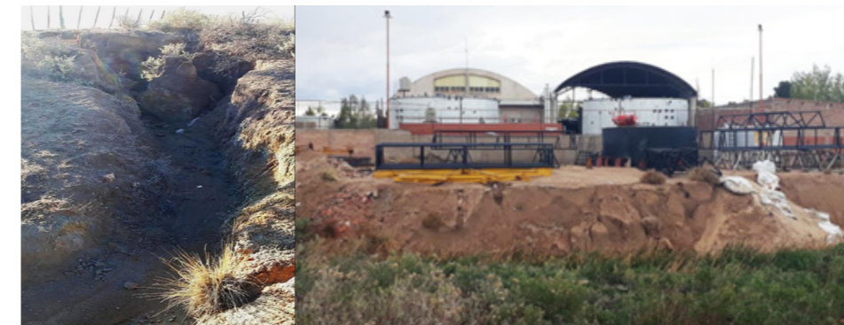
▲ Imagen 8. (izq.) Cárcava en sectores aledaños al canal en su sector medio- (Der.) Deslizamientos en bordes no cohesivos, en el sector industrial de Plaza Huincul. Fuente: Dirección de Medio Ambiente Plaza Huincul, 2023.
