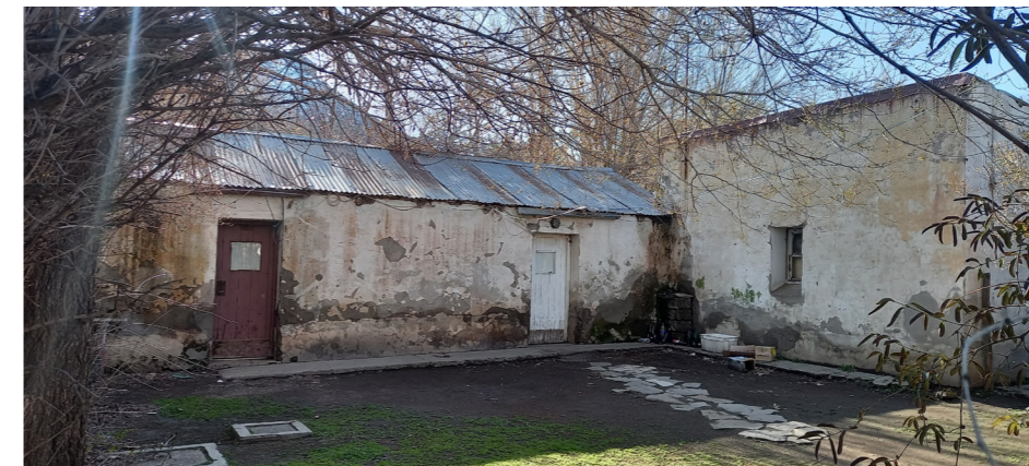
▲ Imagen 16. Estado actual del edificio de correos, el cual espera ser convertido en un museo. Fuente: ONU-Habitat, 2023.
