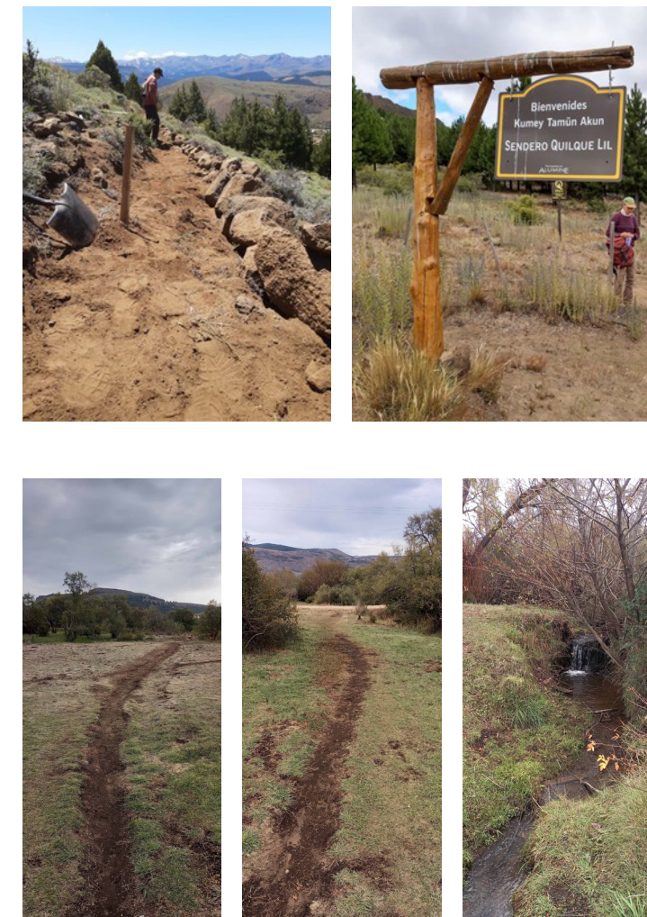
◀ Imagen 9. Izq. Obras de consolidación de senderos en RNU Quilque Lil. Der.: Cartel en uno de los ingresos. Fuente: Duboscq Carra et al., 2023.
